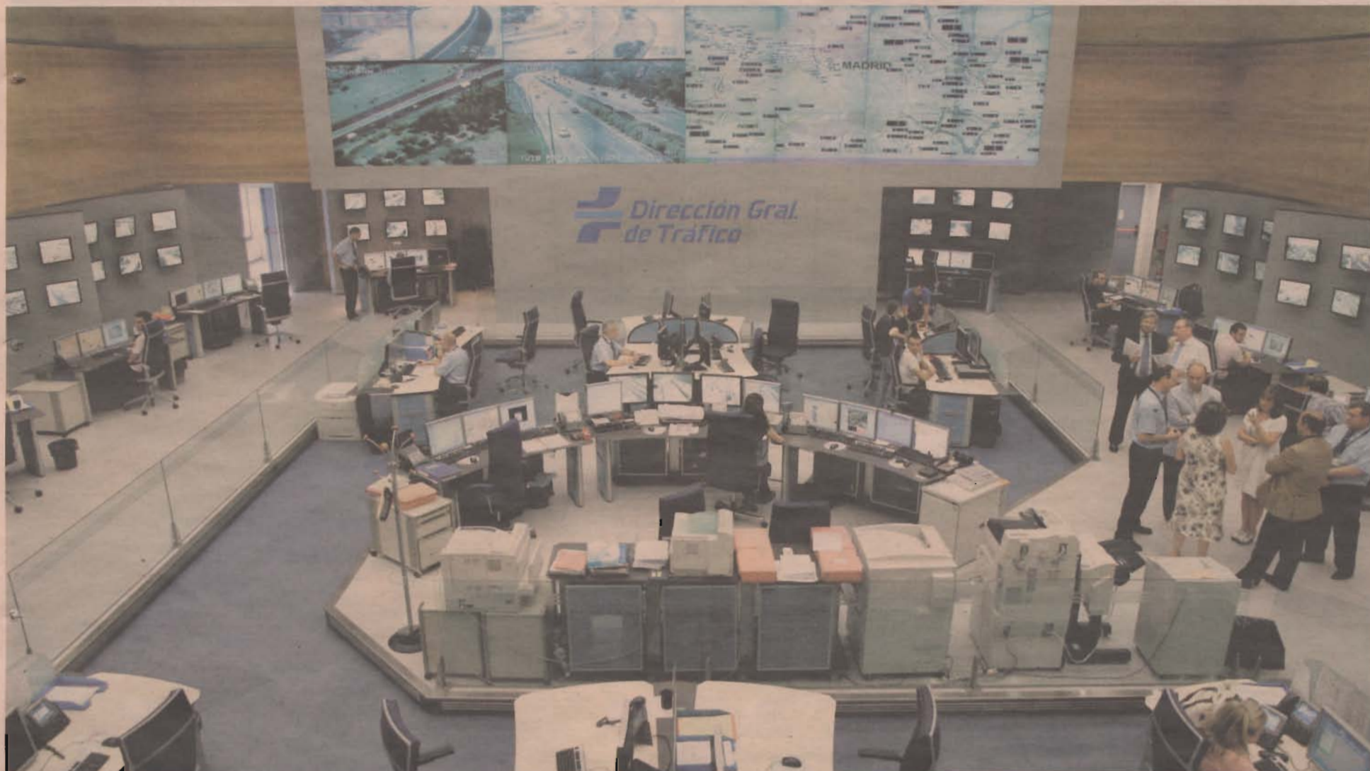
Control de carreteras. La extensión del patrimonio viario español, formado por 166.000 km. de carreteras y 15.000 km. de autopistas y autovías, exige un control constante. / DGT
